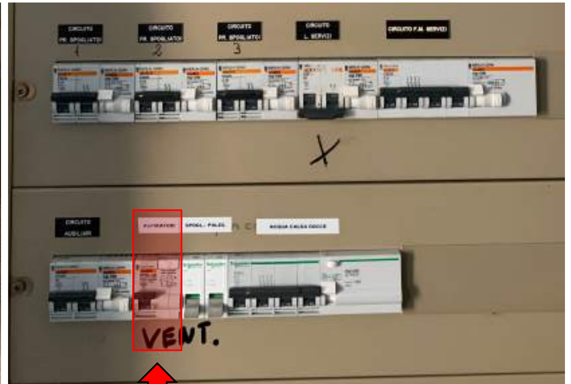
QUADRO ELETTRICO PALESTRA PICCOLA
