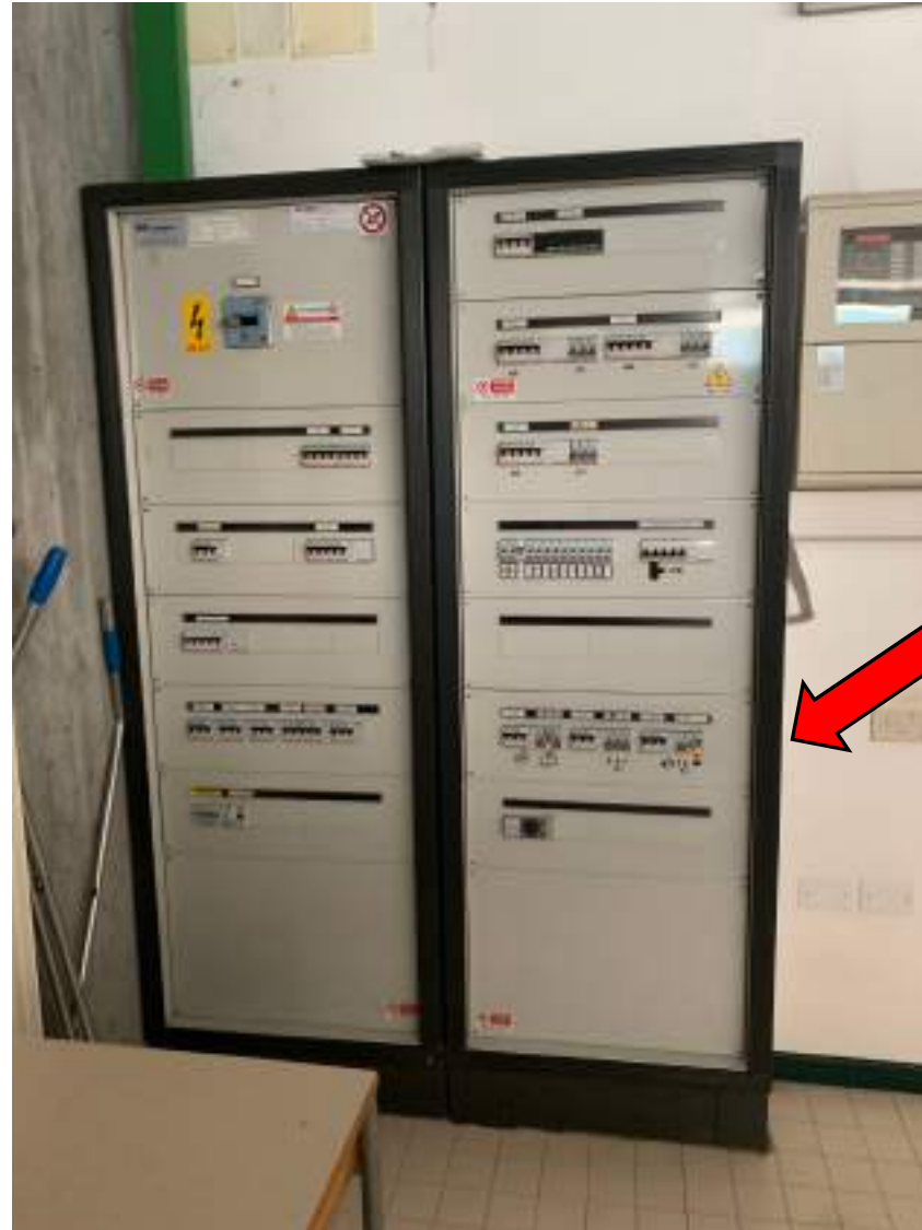
QUADRO DI INTERSEZIONE VENTILAZIONE
